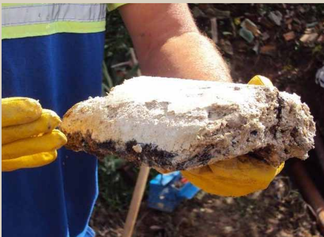
ABAIXO - Crosta sólida de gordura encontrada na rede coletora de esgoto
